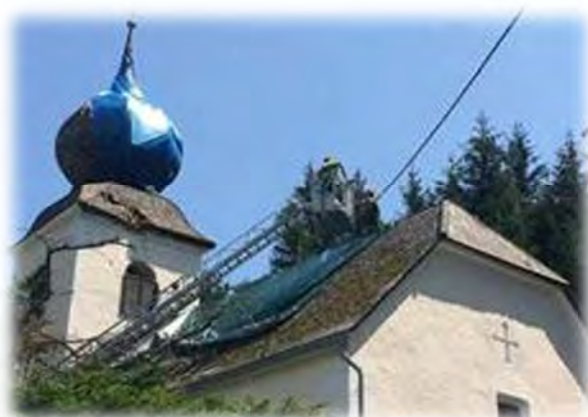
Ein umgestürzter Baum beschädigte das Dach und die Turmkuppel schwer.
