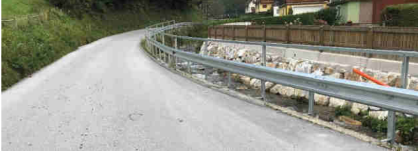
Leitschiene mit Sicherheitsgeländer für Fußgänger
